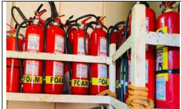
Extintores de incendio
