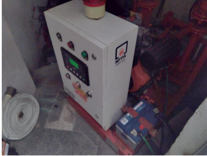
Fotografía 18. Baterías de plomo para funcionamiento de motores de la bomba contra incendios
