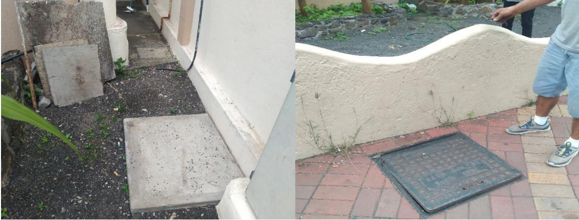
Fotografía 22. Pozo tri cameral sellado ubicado en el edificio principal del hotel
