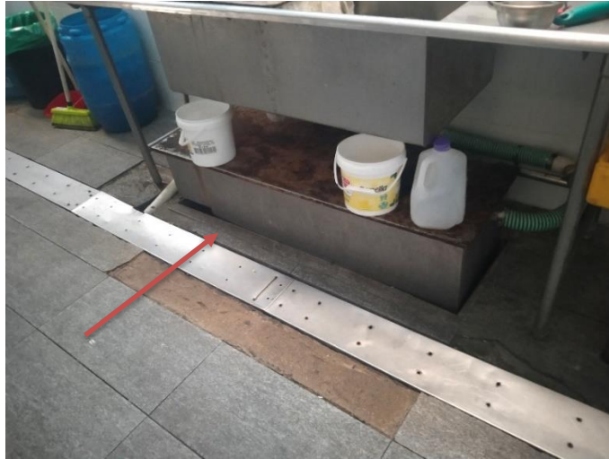
Fotografía 20. Trampa de grasas y aceites en área de cocina del proyecto Fuente: Equipo Técnico
