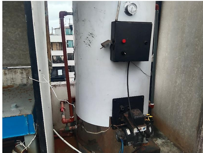
Fotografía 14. Termostato ubicado en la terraza de Torre Isla Sol Fuente: Equipo Técnico
