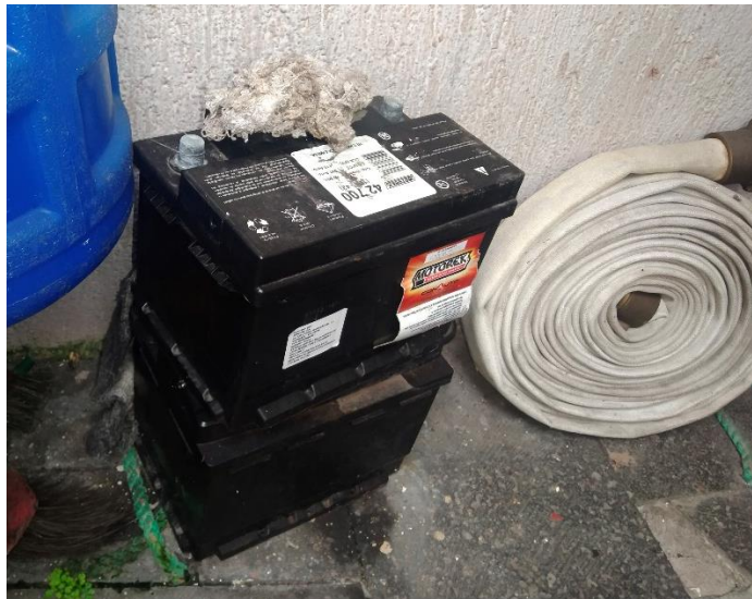
Fotografía 19. Baterías de plomo que han perdido su vida útil, identificadas en el cuarto de la bomba contra incendios.
