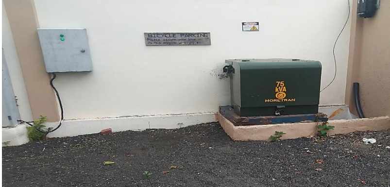
Fotografía 12. Transformador para abastecimiento de energía eléctrica Fuente: Equipo Técnico
