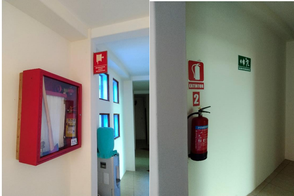
Fotografía 16. Equipos móviles contra incendios. Fuente: Equipo Técnico
