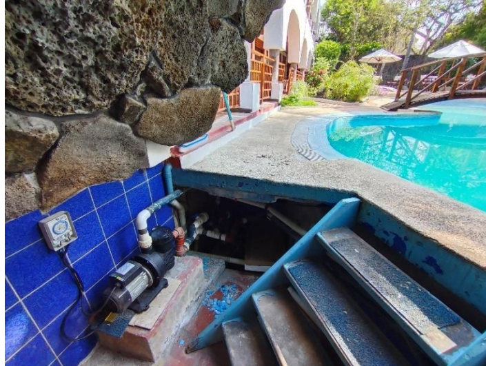
Fotografía 18. Bomba de agua en el área de piscina Fuente: Trabajo de campo equipo consultor, enero 2023
