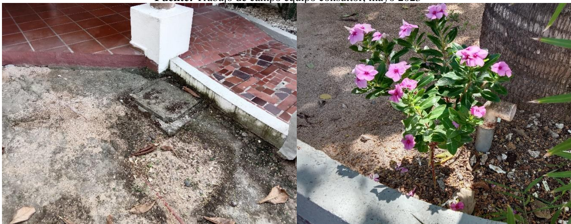
Fotografía 12. Caja de revisión del pozo séptico y chimeneas de desfogue en el área del jardín
