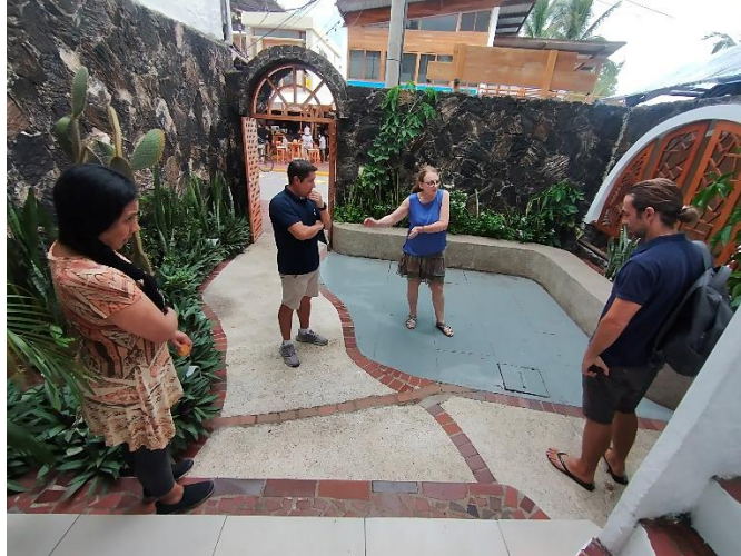
Fotografía 13. Inspección de los pozos sépticos en conjunto con equipo consultor, especialista en PTAR y proponente del proyecto
