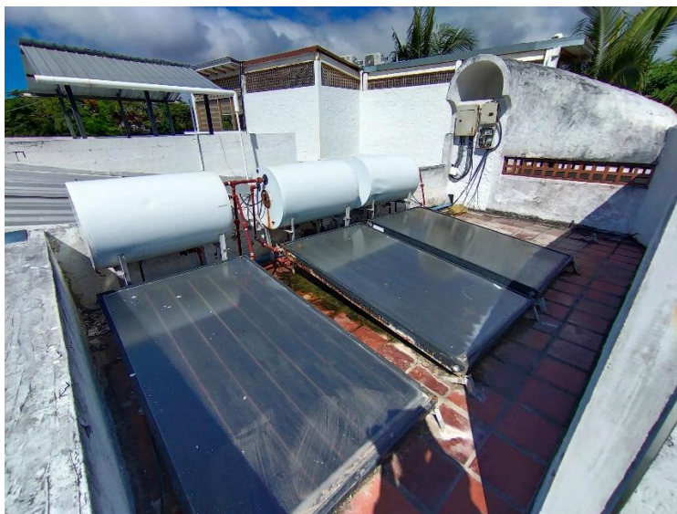
Fotografía 17. Paneles solares ubicados en la torre de ingreso principal del hotel
