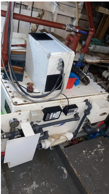
Figura 14 PLANTA DE TRATAMIENTO DE AGUAS NEGRAS
