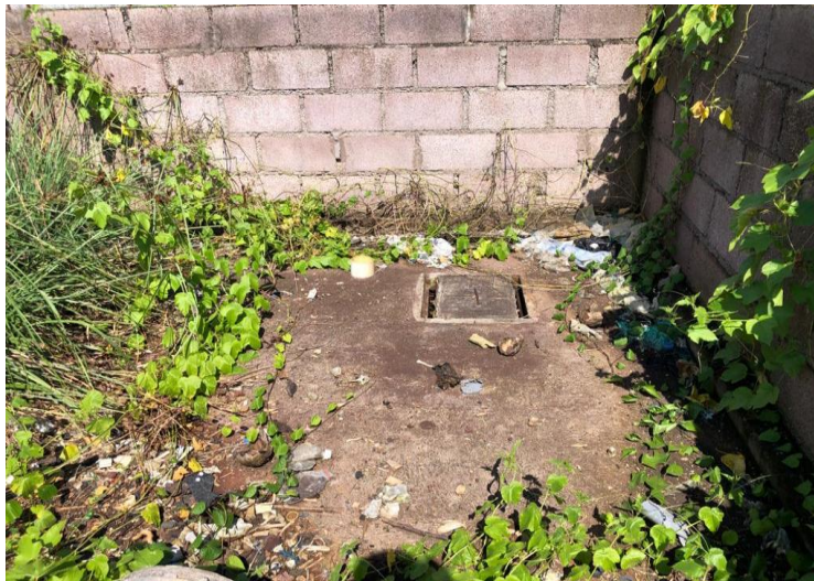
Fotografía 21. Caja de revisión de lixiviados del área de compost Fuente: Trabajo de Campo, Equipo Consultor, marzo 2021
