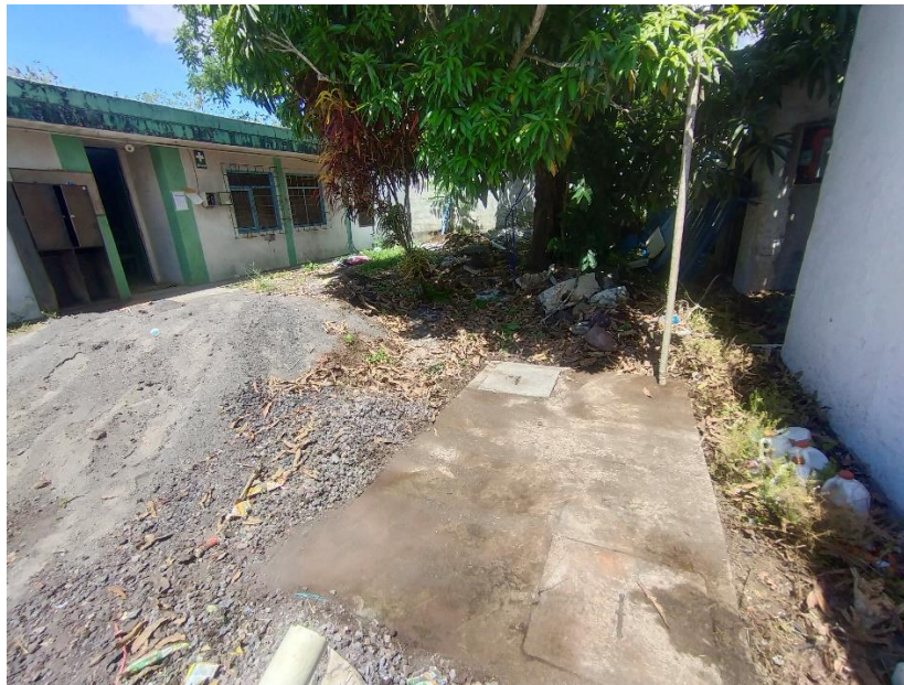
Fotografía 43. Pozo séptico ubicado frente al edificio de la oficina principal Fuente: Trabajo de Campo Equipo Técnico, marzo 2023
