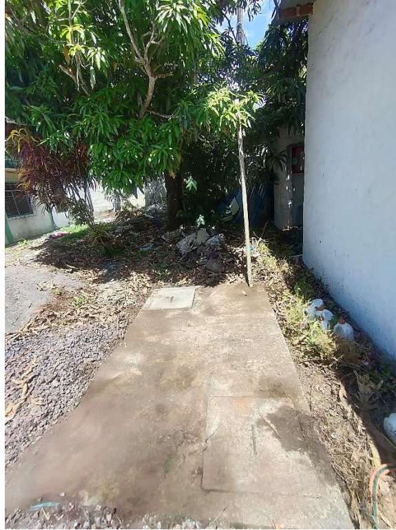
Fotografía 44. Vista de cajas de revisión de cada cámara del pozo séptico ubicado frente al edificio de la oficina principal
