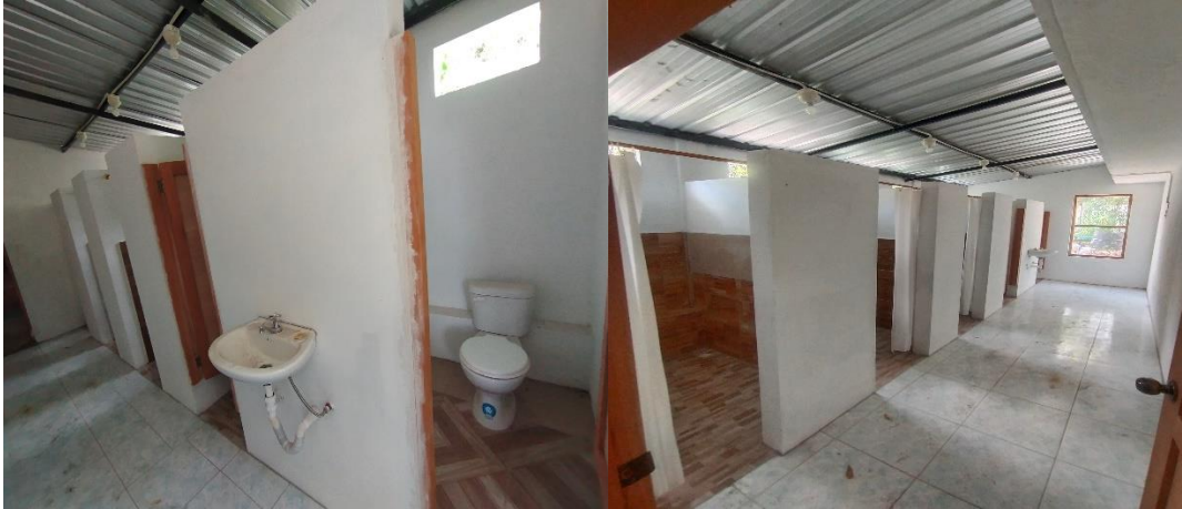
Fotografía 42. SSHH y duchas ubicadas en el edificio de la oficina principal Fuente: Trabajo de Campo Equipo Técnico, marzo 2023
