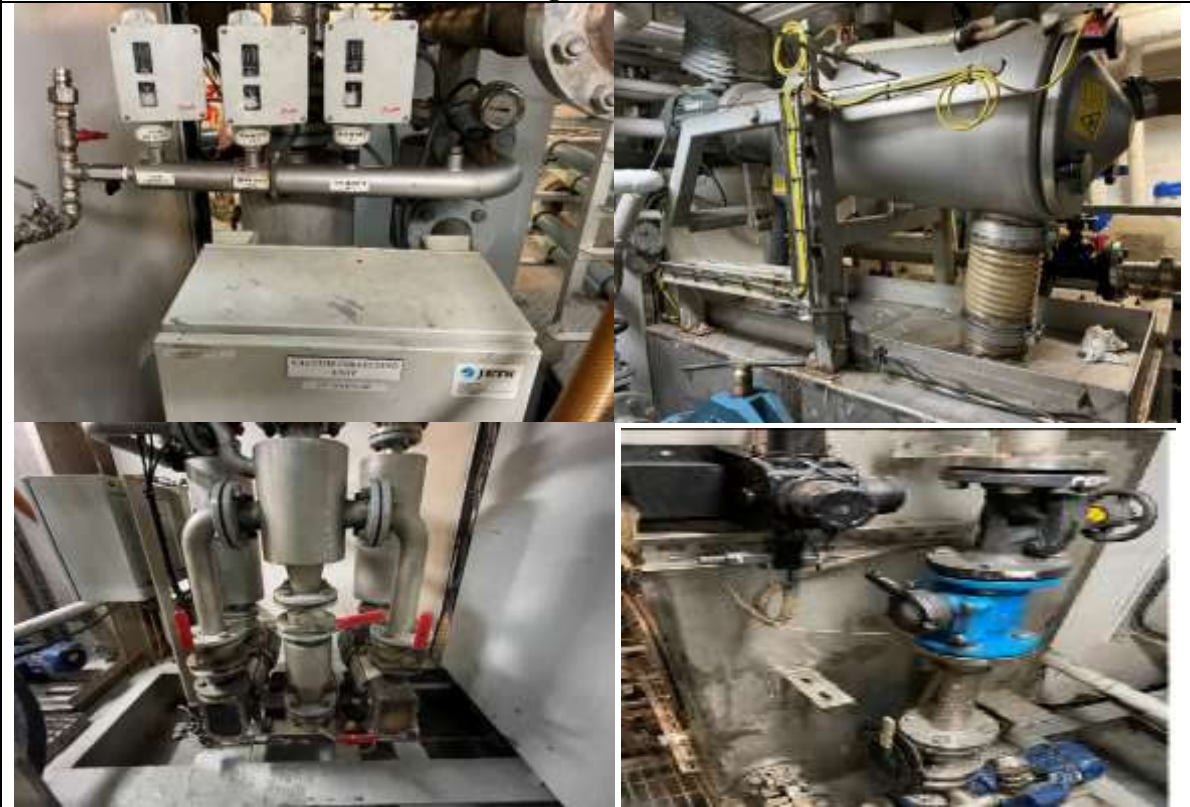
Planta de Tratamiento de aguas negras/grises
