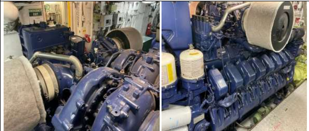
Motores Principales (Main Diesel Engines-MDE)
