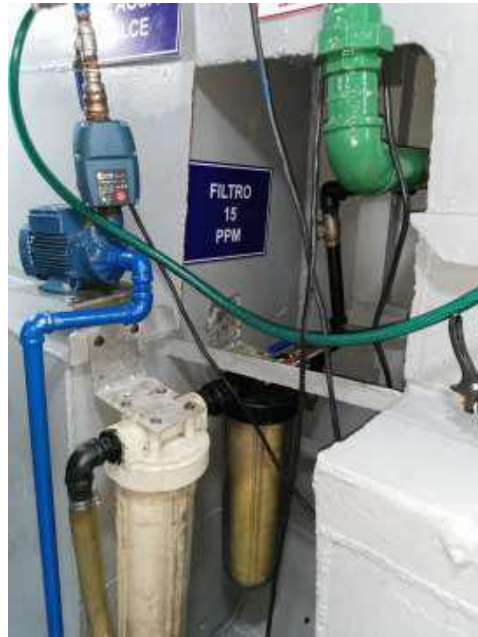
Fotografía No. 25 Filtros separadores de aguas de sentinas
