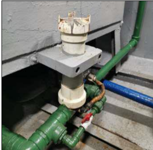
Fotografía No. 23 Planta de tratamiento de aguas negras y grises
