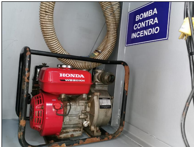
Fotografía No. 21: Bomba contra incendio portátil.
