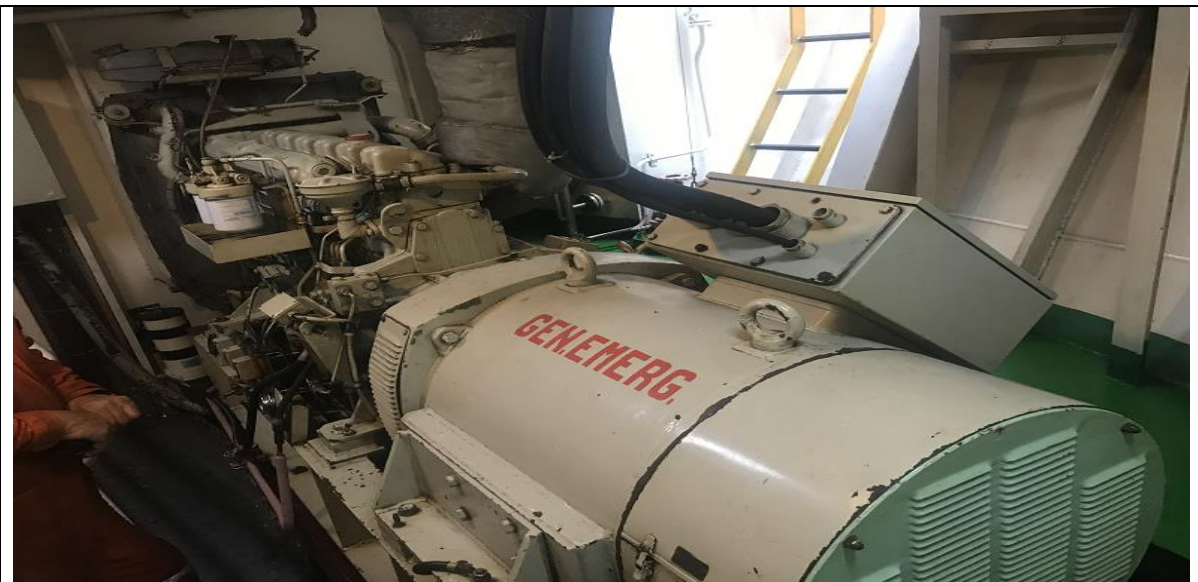
Generador de emergencia
