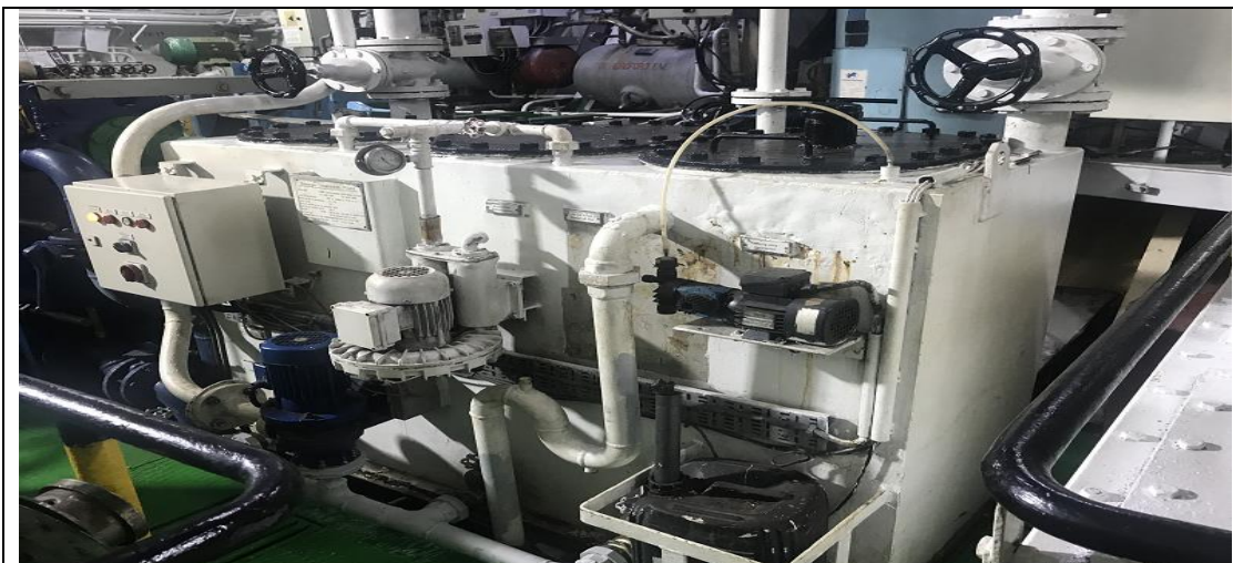
Planta de tratamiento de aguas residuales
