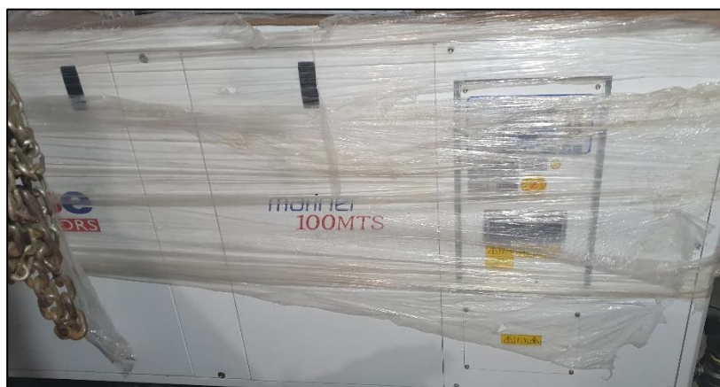
FOT. No. 13: Generador MASE
