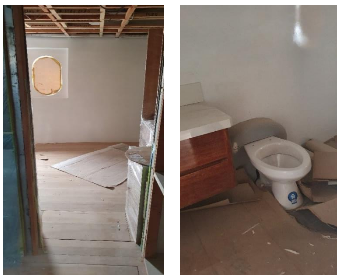
FOT. No. 18: Habitabilidad-Cabinas pasajeros
