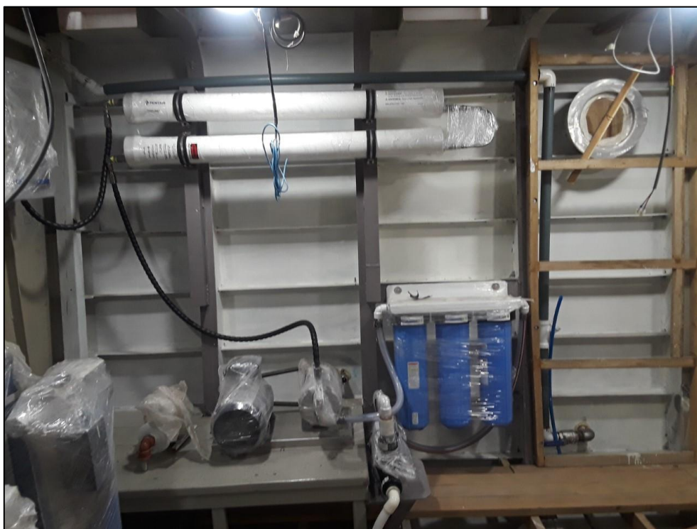
FOT. No. 16: Planta Desalinizadora de agua dulce
