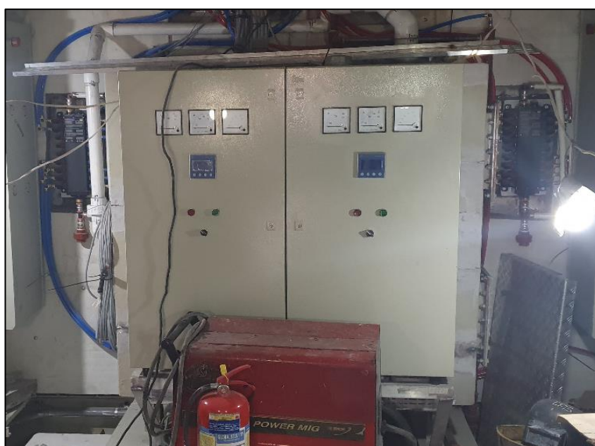
FOT. No. 14: Tableros de control eléctrico
